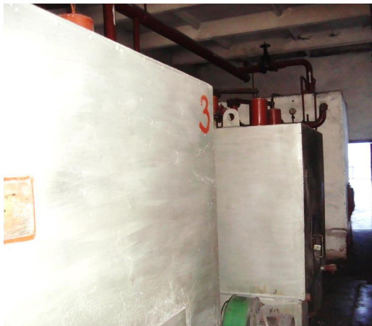
Рисунок 1.3 – Котлы «КВВ-0,6» и «КВ-0,8-95Р» установленные на котельной с. Зубовка
