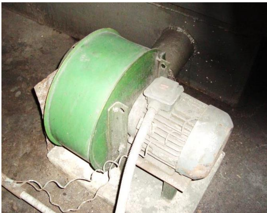
Рисунок 1.6 – Дугевоу вентилятор котельной с. Зубовка
