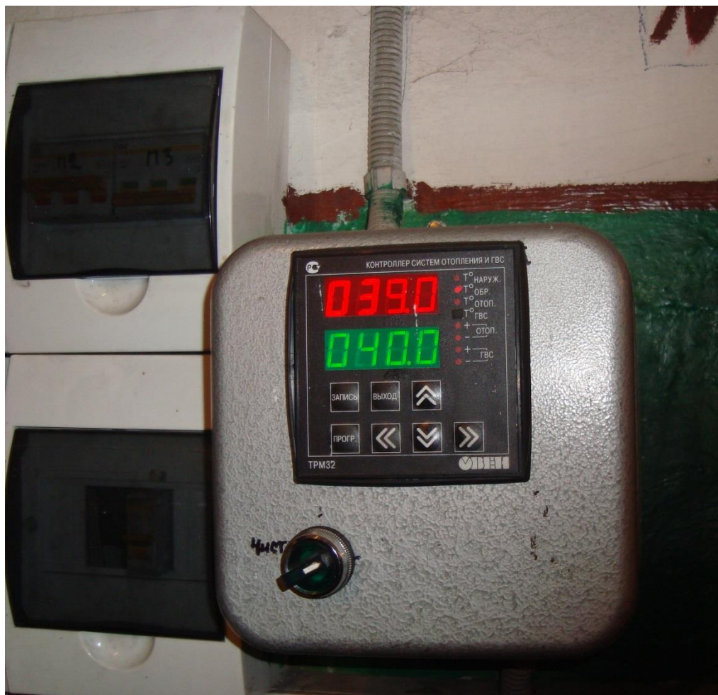
Рисунок 1.8 – Контроллер системы отопления, установленный на котельной с. Зубовка
