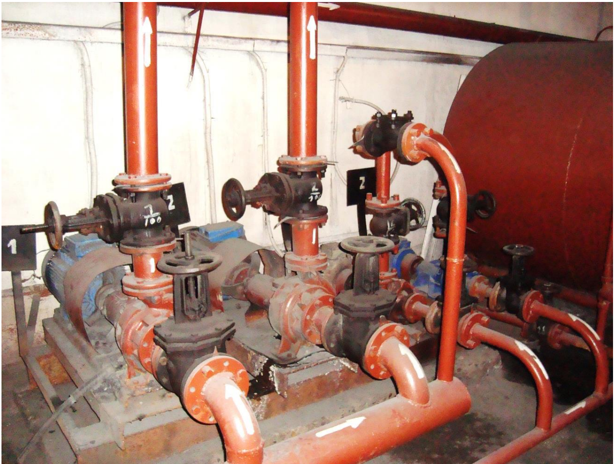
Рисунок 1.4 – Насосное оборудование котельной с. Зубовка
