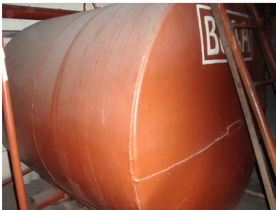
Рисунок 1.7 – Бак запаса подпиточной воды котельной с. Зубовка
